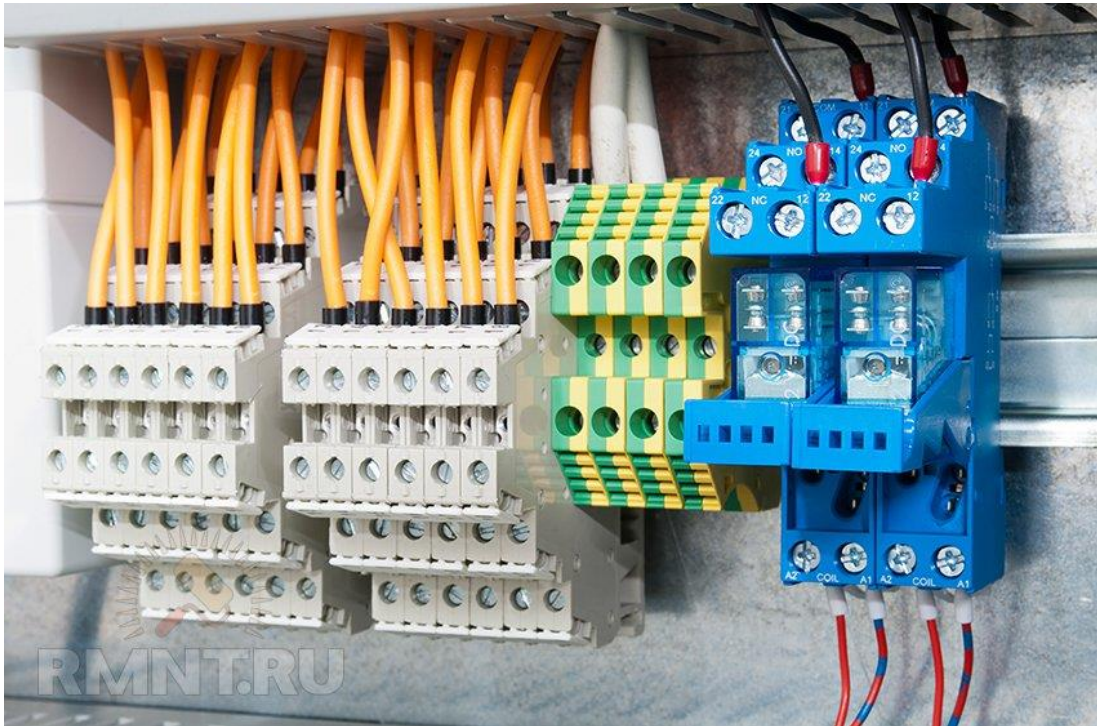
Рис.4. Шины для нейтрали (ноля) и заземления.
